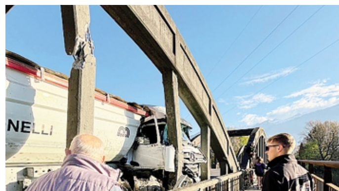
Sorico, il manufatto danneggiato dal camion che ha perso il controllo
